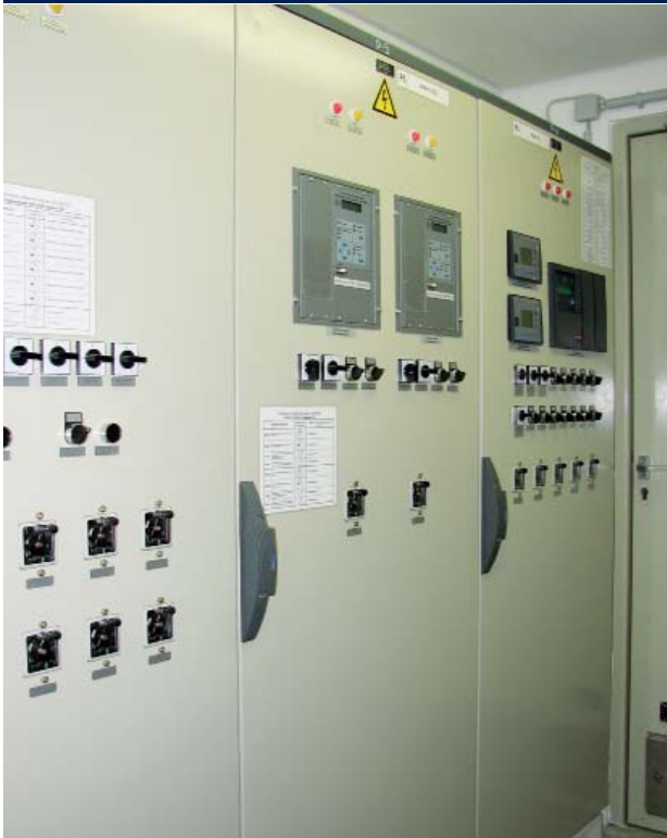
Рис. 2. Общий вид оборудования ОПУ
